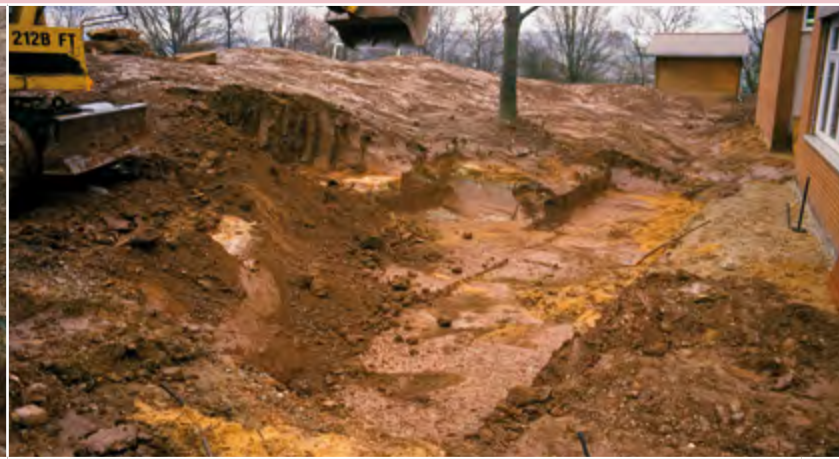
Fast fertig modelliert. Der Bagger 4+8 ist mit der Teichgrube durch, sie misst im Aushub an der breitesten Stelle etwa 8 x 4 m. Hinten am Auslauf nur 2 m. Links wird noch gearbeitet. Hier entsteht später ein großer Teichbeobachtungssitzplatz.
