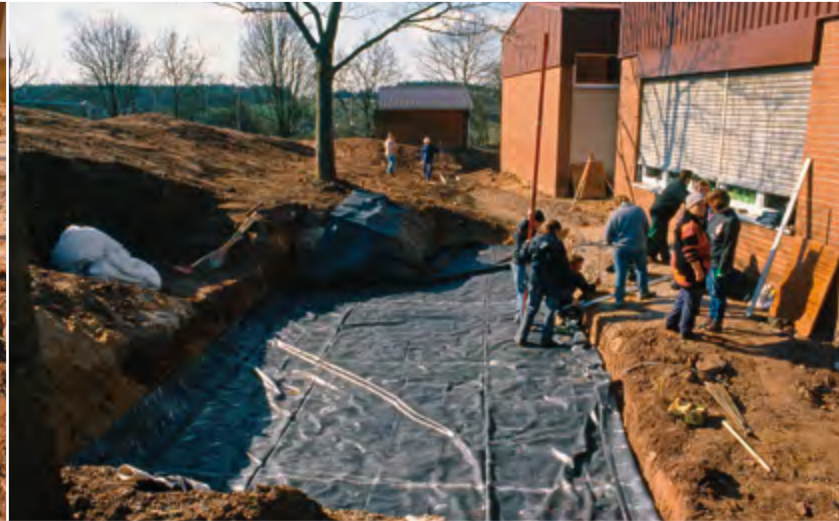
Folie und Uferrand. Passend bestellte EPDM-Kautschukfolie wird ausgerollt und der Höchstwasserstand am Uferrand ausnivelliert. Das Wasser soll ja an keiner Seite vorzeitig und vor allem ungeplant 9 verschwinden. Inzwischen wird der Bauleiter dringend gesucht. „Steeeeeäähhfan!“
