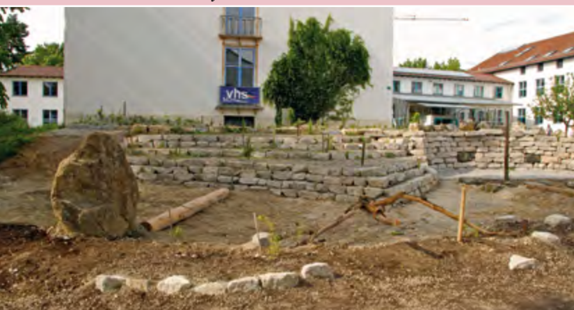
Frisch gebaut von vorne. Aus Abbruchmauerstücken entstand bei Murnau eine siebentrep-pige Sitzlandschaft mit Ausguck aufs Wasserspielgelände.
